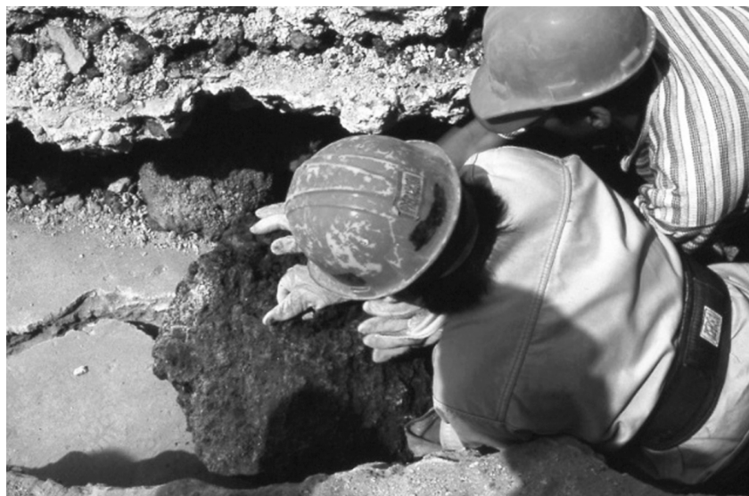
Figura 8. Cuarteadura en el extradós de bóveda.
